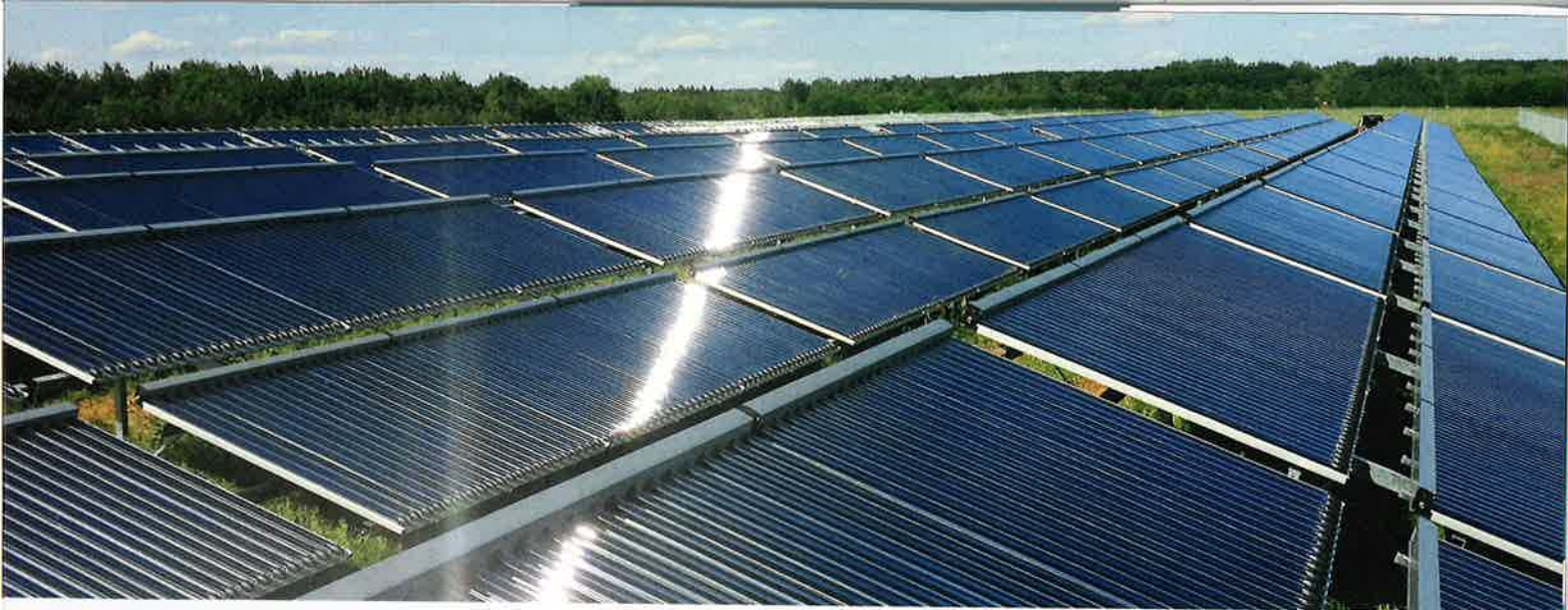
Sonnenenergie unterstützt im europäischen Umfeld bereits seit Jahren die Fernwärme, auch in Senftenberg (D), wo eine Anlage mit 1680 Vakuumröhrenkollektoren in Betrieb steht. (Bild: Ritter XL Solar)
